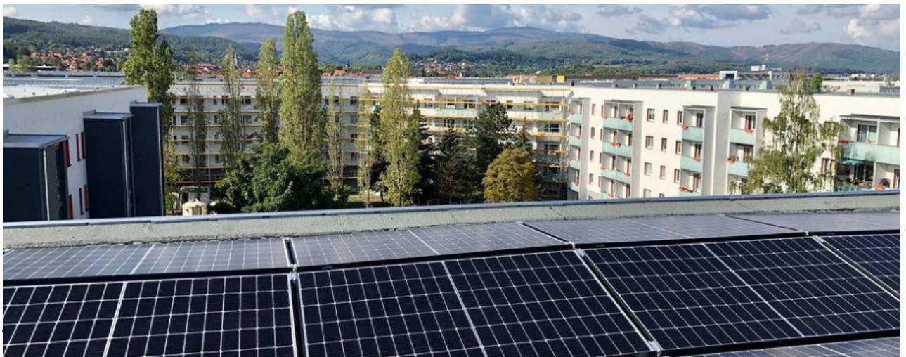
Abbildung 104: Beispiel für Solaranlagen auf Plattenbauten in Wernigerode Quelle: Reuß 2022
